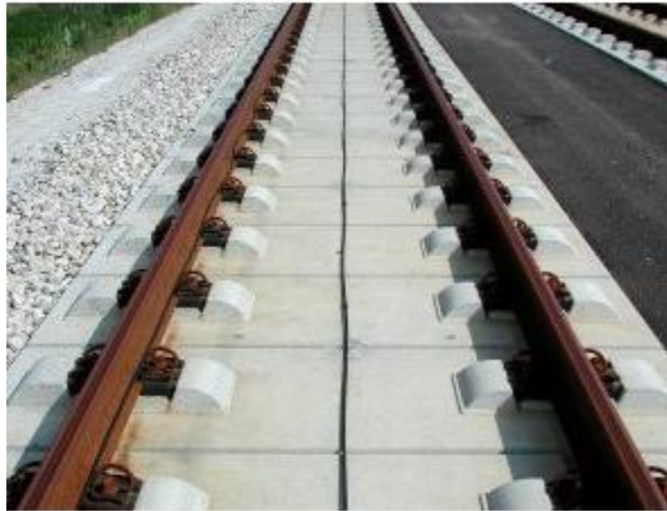
Figura 7. Vía en placa Rheda 2000
